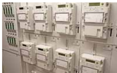
Messstation im Haus C.
